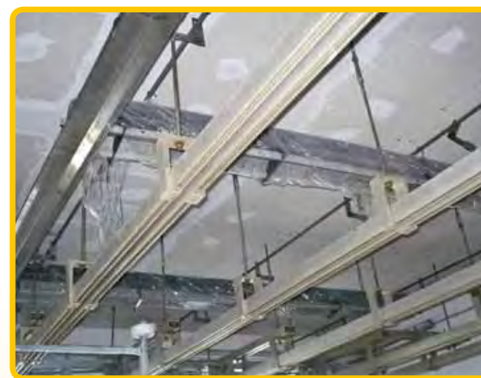
LASTRE IN SILICATO DI CALCIO A PROTEZIONE DI SOFFITTO POSIZIONATE SU STRUTTURA METALLICA DI SOSTEGNO
